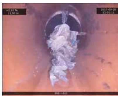
ŚMIECI W KANALIZACJI SANITARNEJ – ZDJĘCIE SKOCZÓW
